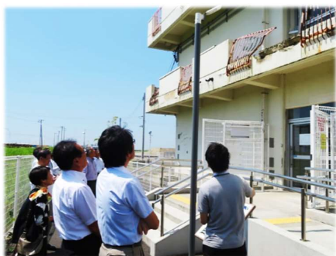
東日本大震災の爪痕が残る校舎
